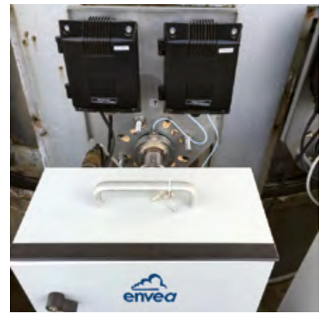
ONLINE-ÜBERWACHUNG IM KAMIN ODER KANAL
