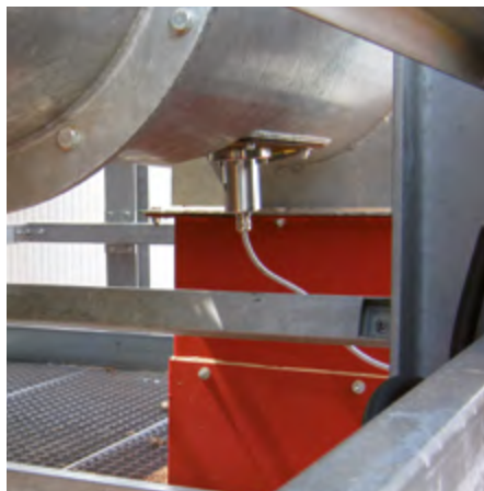
MESSUNG IN EINER FÖRDERSCHECKE
