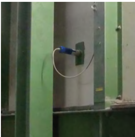
INSTALLATION IN EINER SCHURRE ZUR MIN-LEVEL-DETEKTION
