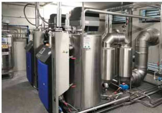
Abb.: Mehrfachdampfanlage. Zweiter nachgeschalteter JUMAG Economiser platzsparend auf Grundgestell installiert
