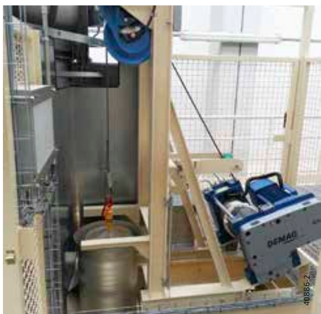
Ortsfestes Hubwerk als Anlagenkomponente
