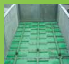
Betonbunker mit 2 bzw. 3 Förder- elementen
