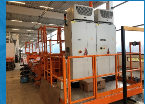
Schaltschränke auf Ladewagen
