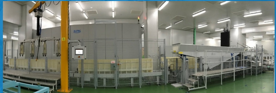
Bruch und Siebanlage
