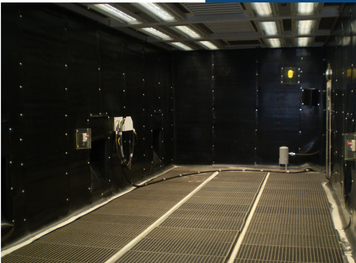
Strahlhausanlage mit Gleisbett
