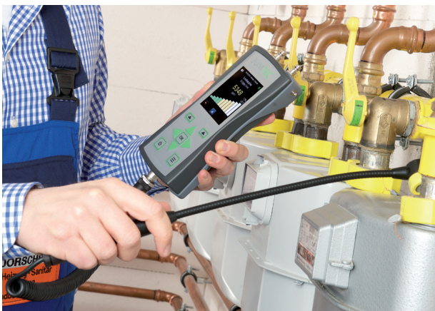
Gaslecksuche mit Erdgassensor
