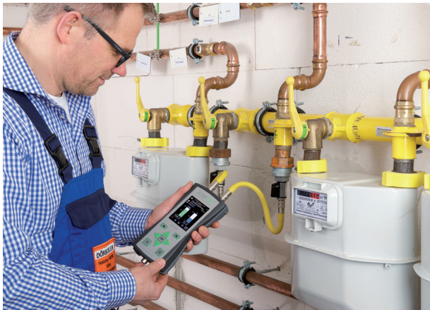
Leckmengenmessung bei demontiertem Zähler
