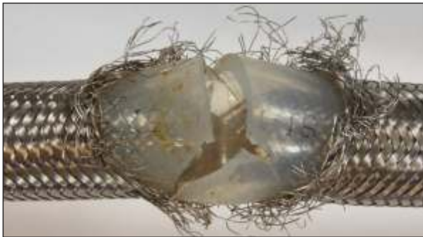
Schadensfall: gerissener Spülschlauch
