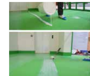
Das Auftragen der abschließenden Schutzbeschichtung mit Bona Pure verleiht der Oberfläche effektiven Schutz.
