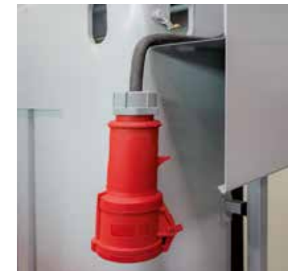
Elektroverbindung hinter der Attikablende
