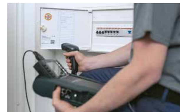
Die dokumentensichere Elektroprüfung gemäß VDE gewährleistet die Sicherheit der Anlagen.
