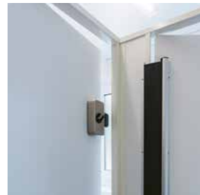
Fingerklemmschutz an Sanitärtür
