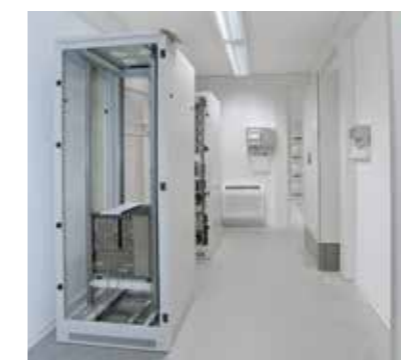
Technikraum und Servertechnik
