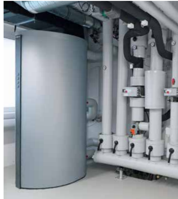
Erdwärmeheizung und -Klimatisierung, Bürogebäude KLEUSBERG, Wissen
