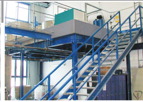
Abwasseraufbereitungsanlage als „abwasserfreie Verdampfungsanlage“
