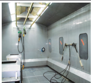
Reinigungskabine mit Hochdruckreiniger für Großteile.
